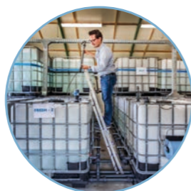
Blue Battery, Delft LOKALE ENERGIEOPSLAG
